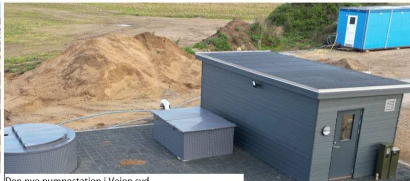
Den nye pumpestation i Vejen syd
